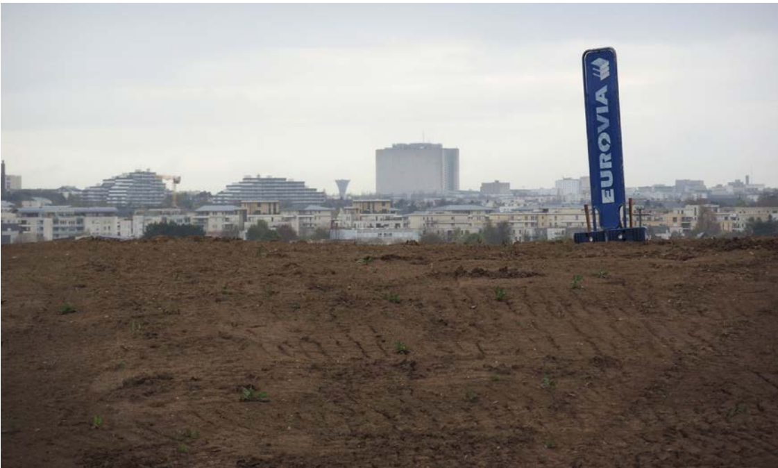
Carpiquet, décaissement des terres agricoles en vue de la réalisation de l'échangeur des Pépinières. Les bonnes terres agricoles ne sont pas de bonnes terres à bâtir... La quantité de sol à exporter avant d'atteindre la roche-mère est considérable, surenchérissant le coût de l'aménagement.
