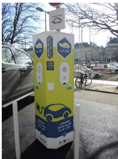
Figure 41 : Borne de recharge pour véhicule électrique installé par le SDEC à proximité du port de plaisance de Caen
